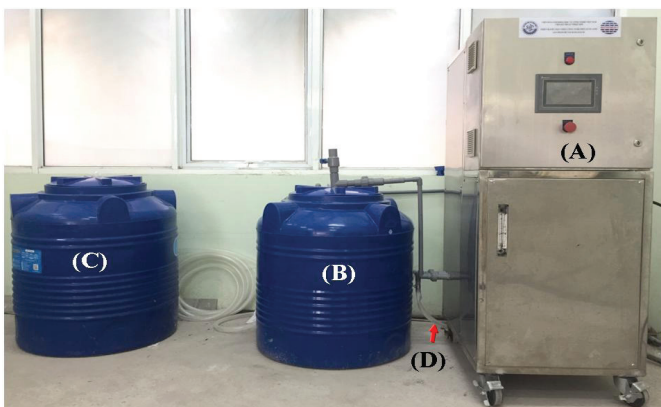
Hình 5. Hệ thiết bị CDI hoàn chỉnh, vận hành thực tế với mẫu nước đầu vào bị nhiễm mặn. (A) hệ thiết bị chính; (B) bồn chứa nước nhiễm mặn; (C) bồn chứa nước thành phẩm; (D) van dẫn nước thải.
