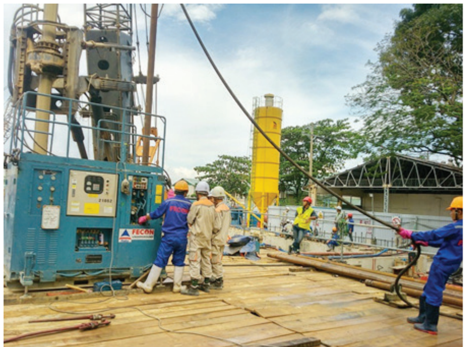
Công nghệ Jet Grouting đã được FECON áp dụng và mang lại hiệu quả cao.
