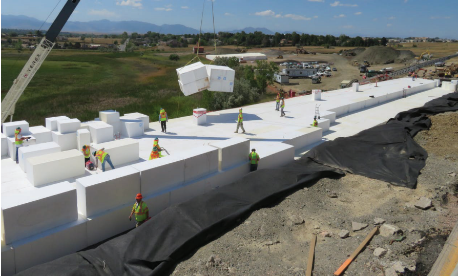
Sử dụng vật liệu nhẹ địa kỹ thuật EPS đắp nền đường thay đắp đất truyền thống [7].
